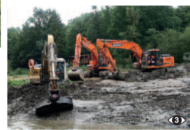
Un atelier de curage composé de trois pelleteuses. Celle qui extrait les sédiments du lit de la rivière est attachée à une pelleteuse en arrière pour lui éviter de s'enliser. Photo © DDTM50/MBS
